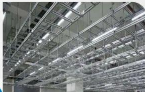
综合管路系统
