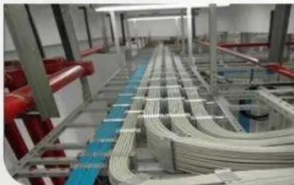
综合布线系统
